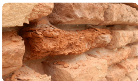
Brique effritée, inapte au réemploi
