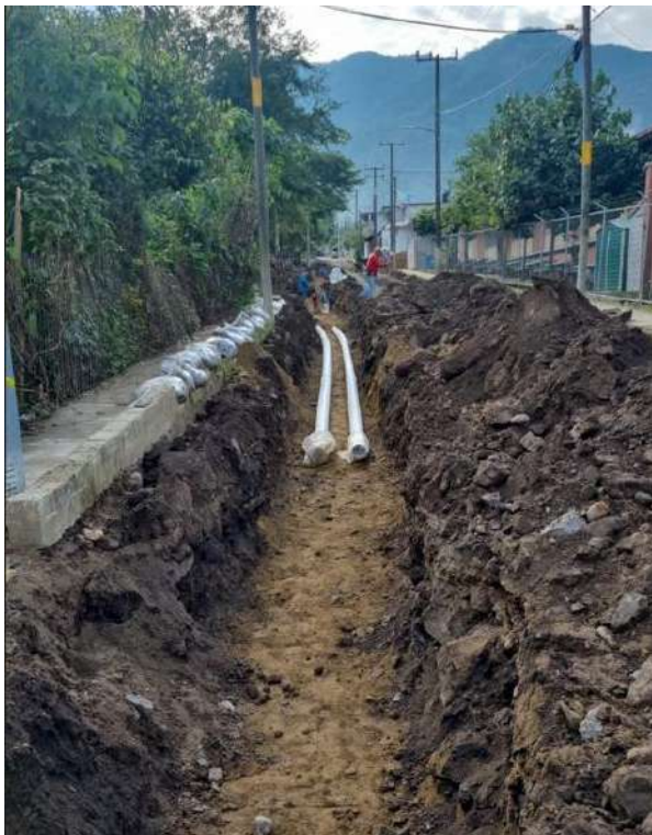
Línea de agua potable en la calle Juárez de la cabecera municipal de Minatitlán, Col.
