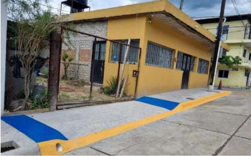
Rehabilitación Integral de la calle Mártires de Tacamo entre las calles Independencia y Emiliano Zapata.
